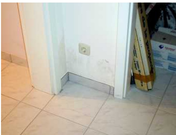
Schimmel an bzw. in der Wand in dem Kellerraum und Flur.
